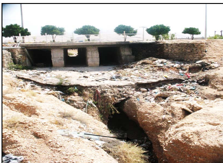
شکل ۹- فرسایش قهقرای بر اثر برداشت رسوبات رودخانه‌ای در رودخانه کتویه
