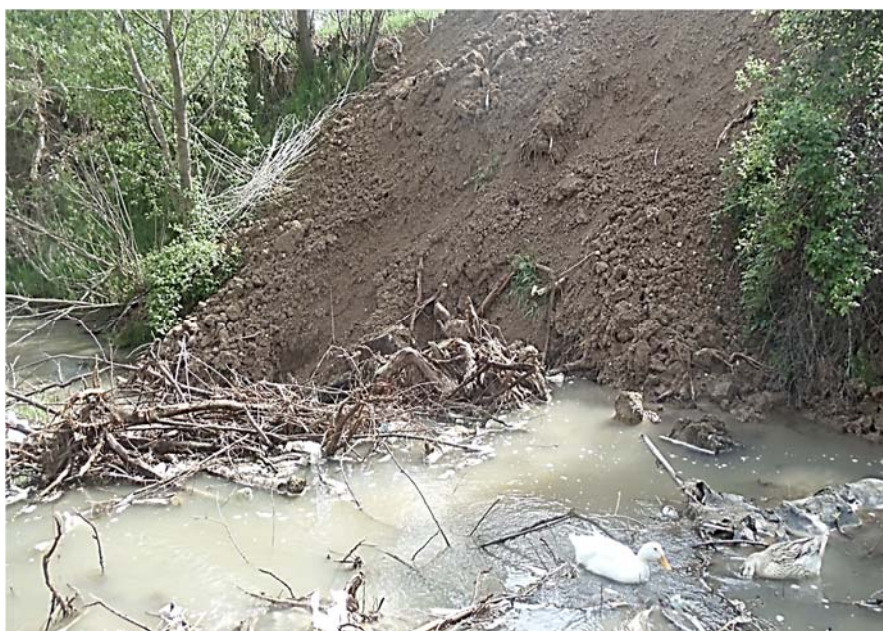
شکل ۶. زیربری رودخانه و ریزش دیواره ها تند به داخل رودخانه
