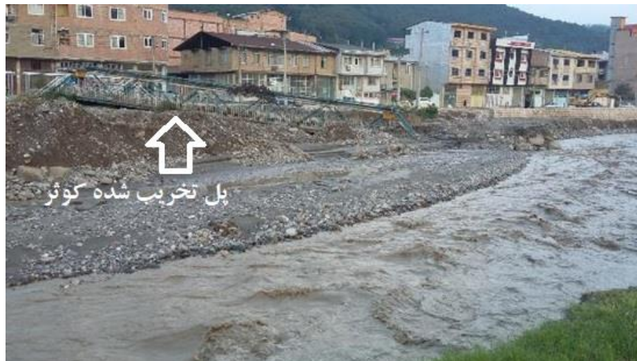
شکل ۱۰: بل تخریب شده کوثر بر روی رودخانه تالار در شهر پل سفید
